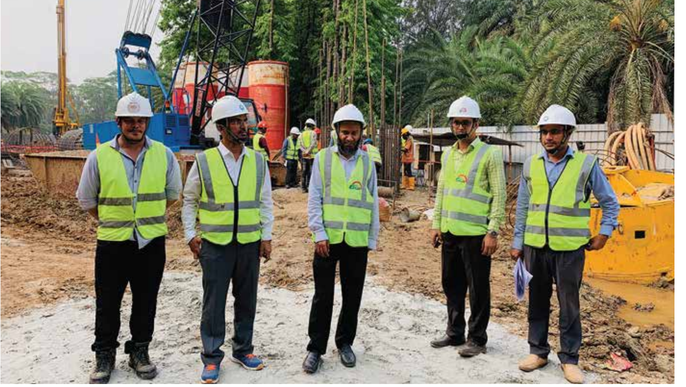
প্রকল্প ব্যবস্থাপক-৩, MRT Line-6 জাতীয় সংসদ এলাকায় Pile Cap-এর নির্মাণ কাজ পরিদর্শন করেন
